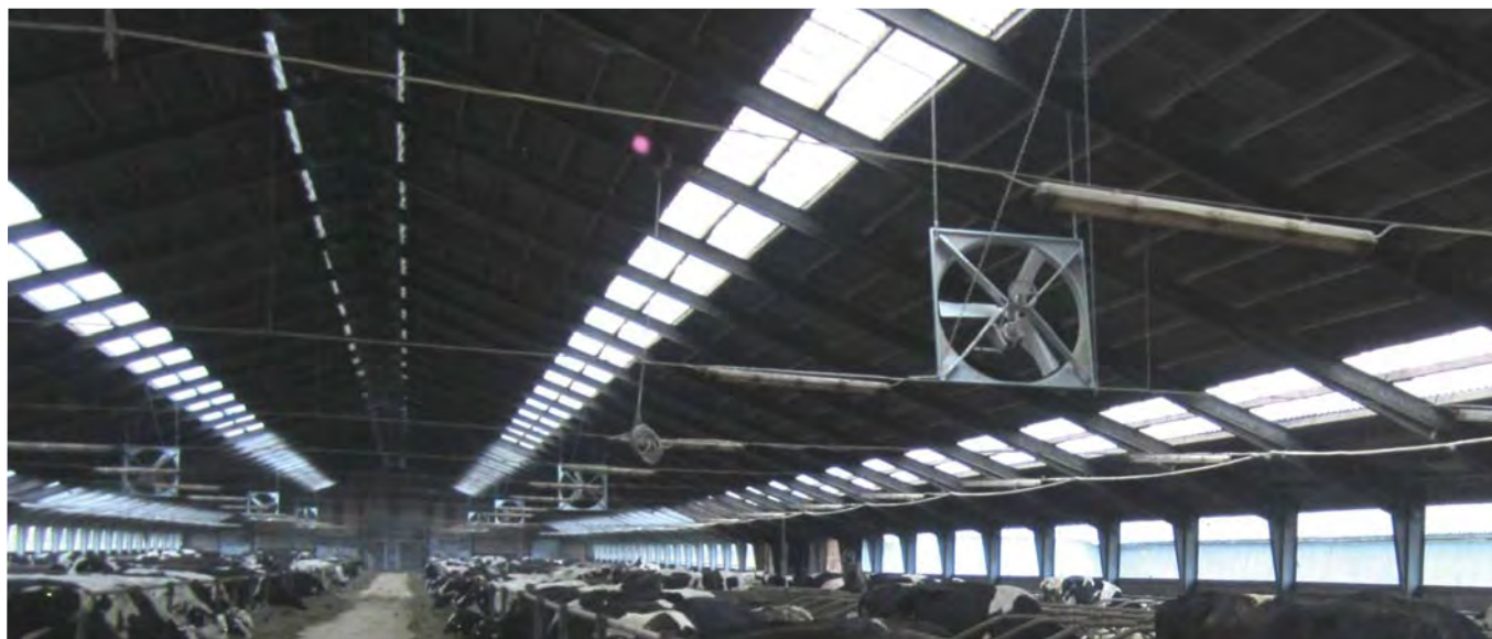
Joonis 34. Vabapidamisega suurlauda ventilaatorid söömis-puhkeala kohal
